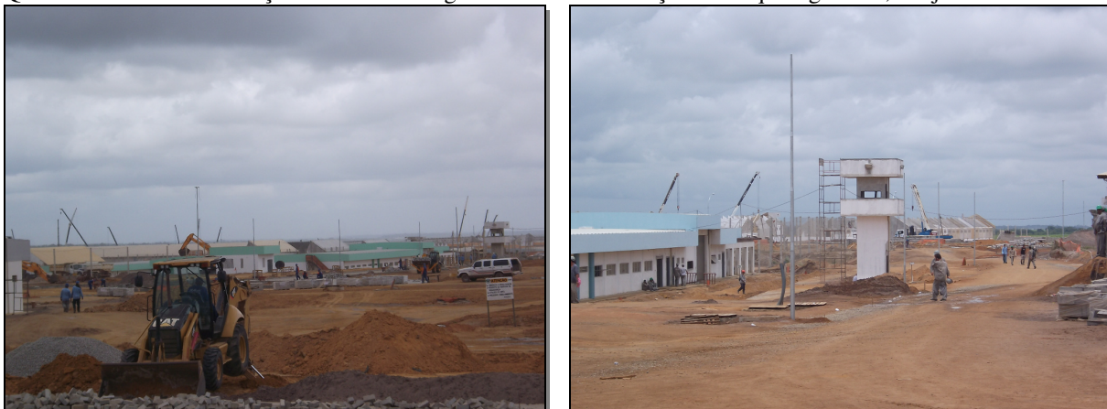
Quadro 3: fotos da construção do Centro Integrado de Ressocialização de Itaquianga – PE, em janeiro/2012.
