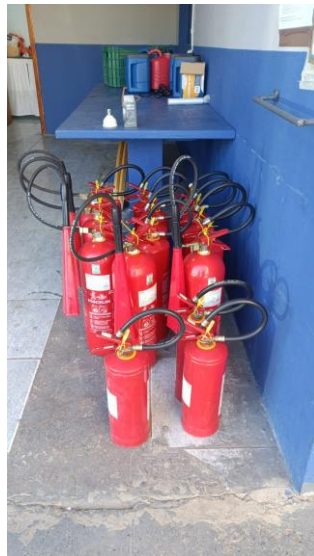
Extintores – registro das adequações relacionadas à segurança e regulamentação da unidade.
